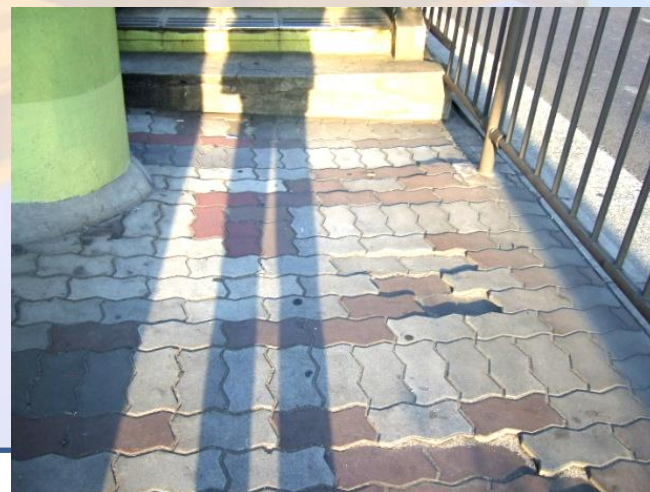
歩道が沈下している写真
